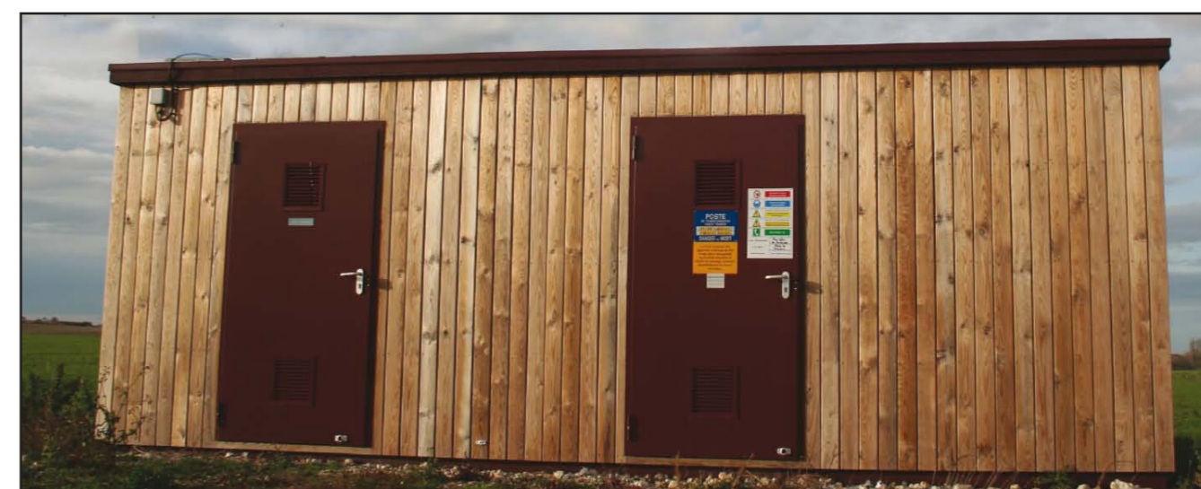
Figure 127 : Poste de livraison type
